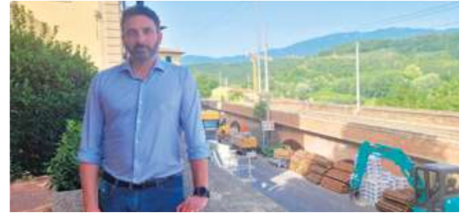
Il sindaco di Rignano, Giacomo Certosi, davanti al cantiere dei lavori Rfi
