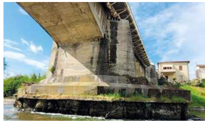
Le condizioni del ponte sull'Arno
